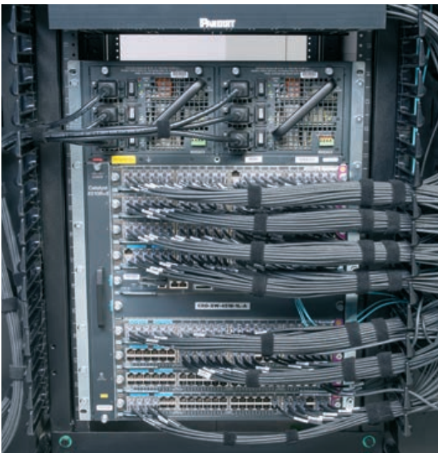
Panduit PoE Switch Rack
