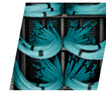
Racks y Administración de Cableado
